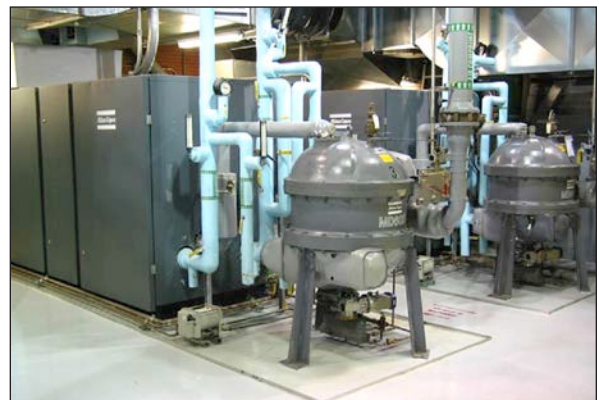
Photo : IBM. L'usine de Bromont a remplacé un système d'aspiration qui utilisait des compresseurs d'air par un système central d'aspiration.
